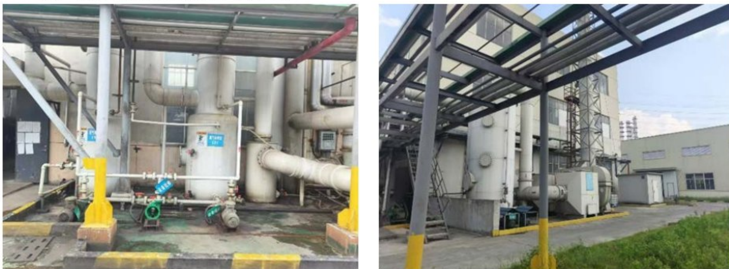
图3.5-1 废气处理装置
